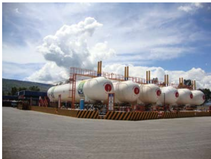
Regio Gas, S.A. de C.V., Planta Chalco
